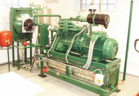
Kogeneračná jednotka / Cogeneration unit // Kogenerationseinheit
