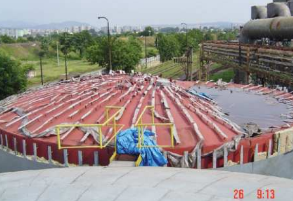
Havária nádrže v TEKO Košice / Tank damage in TEKO Košice heating plant // Havarie des Behälters in TEKO Košice
