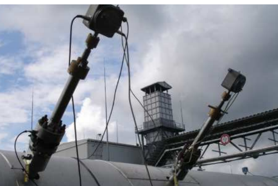
Meranie prietoku pre SPP Veľké Kapušany / Measurement of flow for SPP (Slovak Gas Industry) Kapušany // Durchflussmengenmessung für SPP Veľké Kapušany
