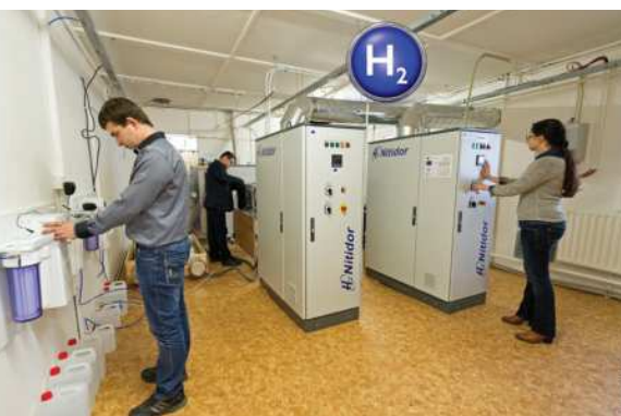
Elektrolyzéry H 2 Nitidor / H 2 Nitidor electrolyzers // Elektrolyser H 2 Nitidor
